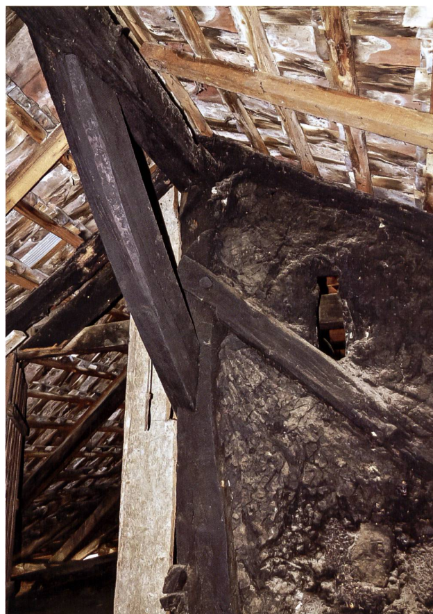
5: Stark verrusster Südgiebel mit bauzeitlicher Rauchöffnung zwischen den mit Lehm und Stroh ummantelten Staken. Foto 2017.
