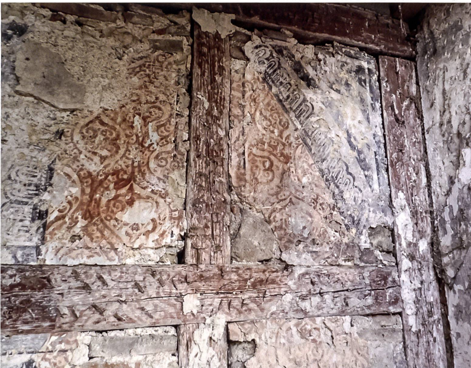
25: Die Vorhangmalerei stammt wohl von ca. 1600. Sie bestand aus einem Brokatmuster in Ockerrot mit einem grauen drapierten Behang. Das Haus wurde 2016 abgebrochen.
