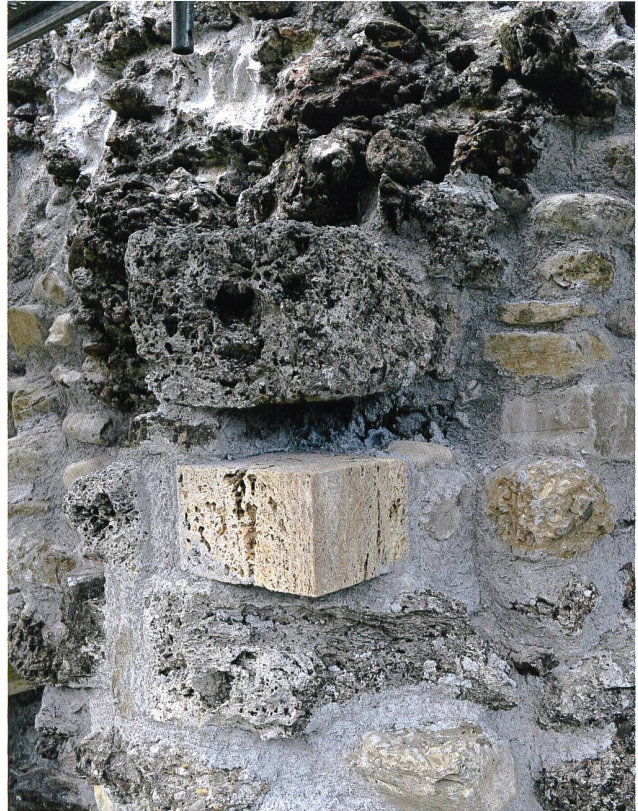
4: Schänis SG, Ruine Niederwindegg, 2020. Ecke M1/M2. Zur Stabilisierung der originalen bossierten Tuffsteinquader eingesetzter Ersatzstein mit glatter Oberfläche, von Norden. Vor dem Schliessen der Lücke wurde zur rückwärtigen Verankerung der Ecke eine Ankerstange aus Chromstahl eingesetzt.
