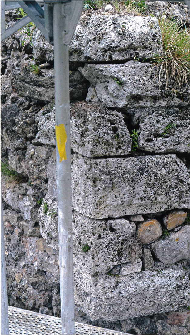
11: Schänis SG, Ruine Niederwindegg, 2020. Ecke M2/M3, Reste des Eckverbandes aus bossierten Tuffsteinquadern, von Osten.
