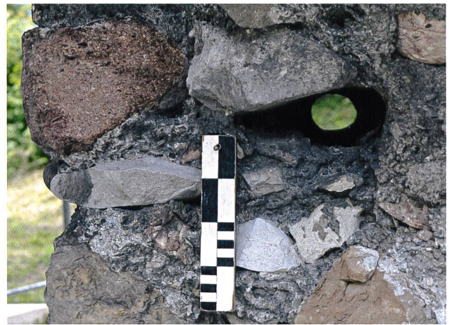
13: Schänis SG, Ruine Niederwindegg, 2020. Mauer M2, Aussenfassade. In seiner Zusammensetzung an Beton-erinnernder Mörtel rund um das Gerüsthebelloch 1.3 (ausser), von Nordosten.
