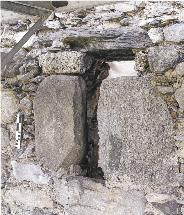
9: Pfäfers SG, Ruine Wartenstein, 2019. Untere Burg, Palas. Mauer M203, Fenster 2.14. Äusseres Fenstergewände aus grob behauenen Steinen von unterschiedlicher Qualität, von Nordosten. Die der Scharte zugewandte Kante der Sandsteinplatte ist grob abgefast. Die unter dem Sturz verbauten Quader sind aus Tuff, wobei der Stein auf der rechten Seite grösstenteils ausgebrochen ist.
