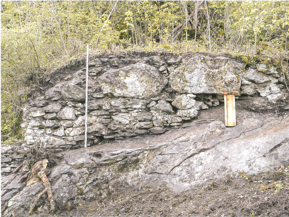
16: Pfäfers SG, Ruine Wartenstein, 2019. Untere Burg, Mauer M215. Freigelegte Front der an ihrer Basis aus auffallend grossen Steinen gefügten Mauer, von Nordosten.
