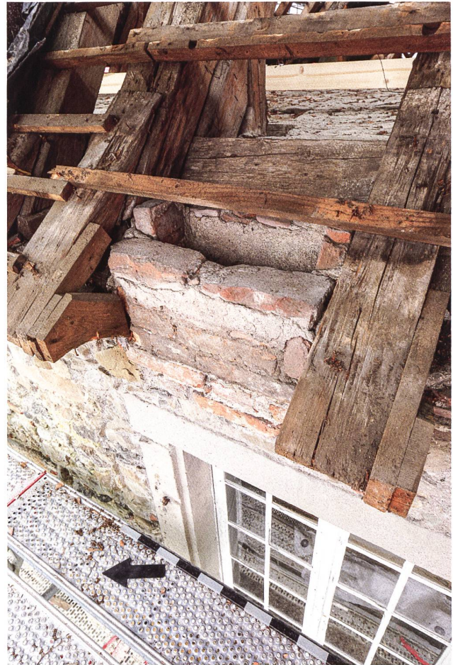
28: Schloss Buonas. Nordwestfassade. Rest eines ehemaligen, in die Mauer der Aufstockung integrierten Kamins in der Mauerkrone. Blick nach Osten.
