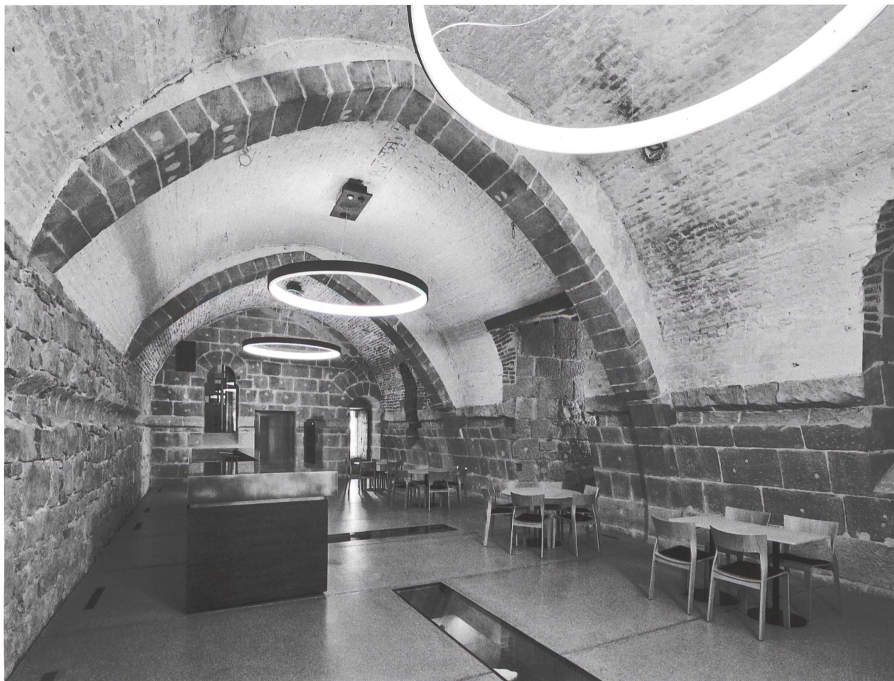
3: Lausanne, Saint-Maire. Arc-doubleau brisé en pierre construit sous de Menthonay, dans la cave nord. Il a été conservé par Challant, malgré l'aménagement sous sa direction de la voûte en plein-cintre en briques.
