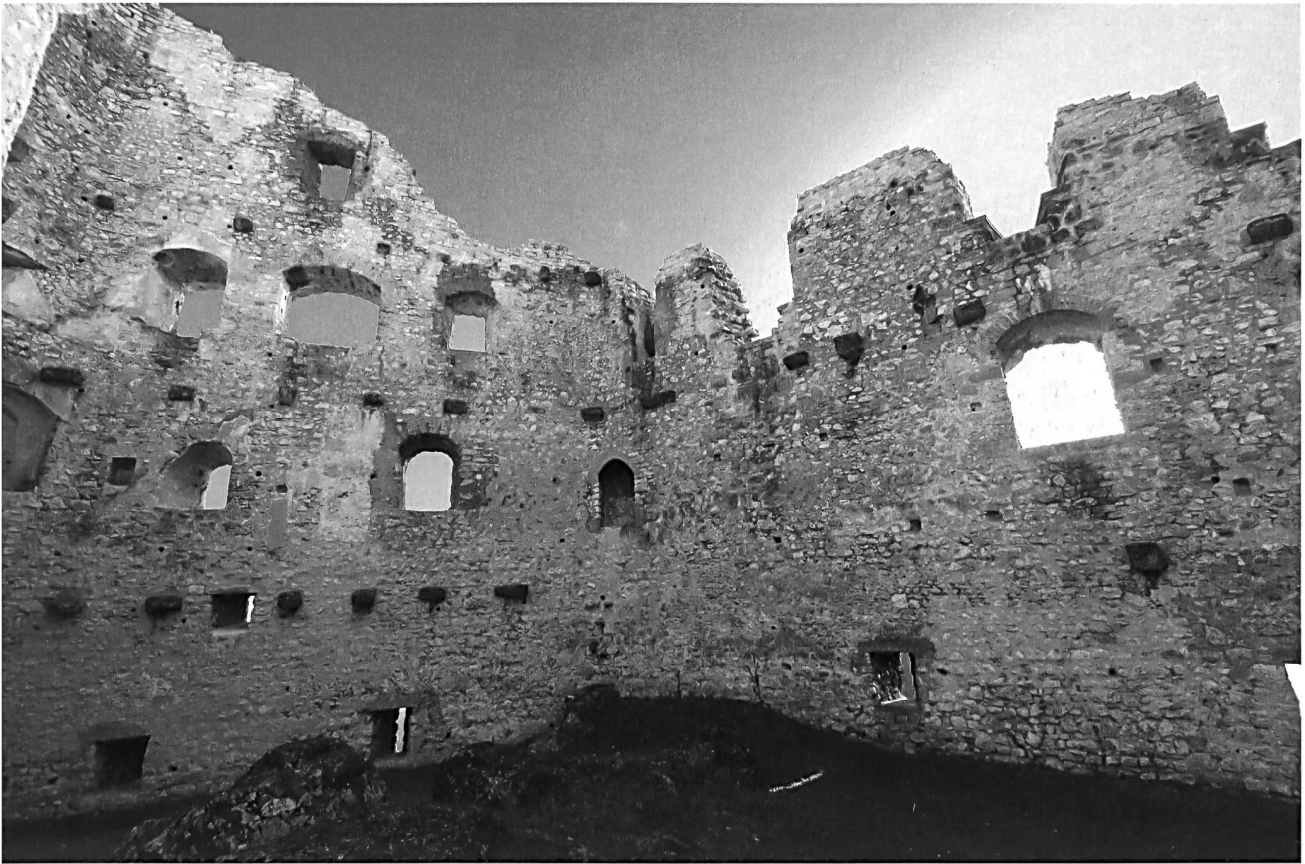
15: Pfeffingen BL. Innenraum des Wohnturms. Blick nach Südosten. Das Erdgeschoss war nie ausgebetet. Zustand 2017 nach der Sanierung.
