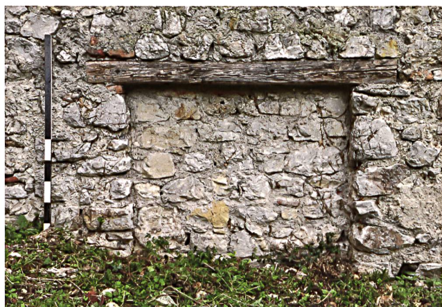
53: Pfeffingen BL. In den 1930er Jahren mit 2/3 der Mauerstärke zugemauertes Fenster im Osten der südlichen Zwingermauer. Foto vor der Sanierung 2013.
