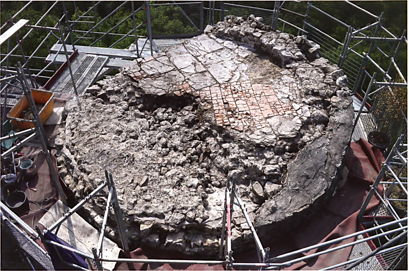
28: Pfeffingen BL. Hexenturm, Reste des Bodenbelags der Wehrplattform und der Brüstung über dem Gewölbe im Obergeschoss. Blick nach Süden.
