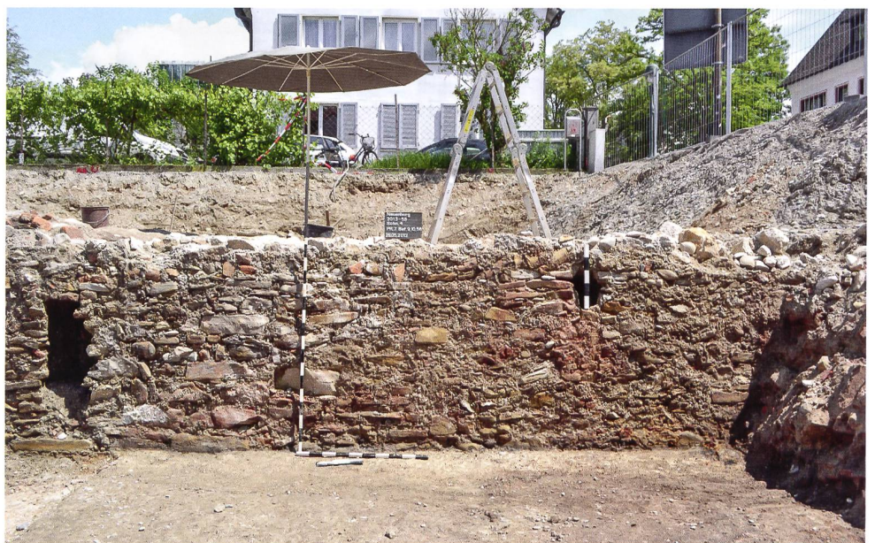
5: Neuenburg am Rhein. Unterfangung der Westwand des ältesten nachgewiesenen Gebäudes mit einer Kellermauer aus der Mitte des 13. Jh.
