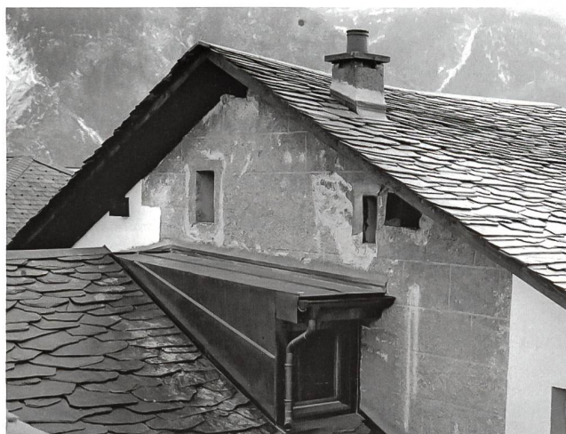
12: Maison Guerrati, pignon oriental après le dernier agrandissement de la maison (phase 3). Détail du crépi à faux-joints imitant un ouvrage en pierre de taille – Ostgiebel nach der letzten Vergrößerung des Hauses (Phase 3). Detail des Verputzes mit Fugenstrich, ein Quadermauerwerk imitierend.
