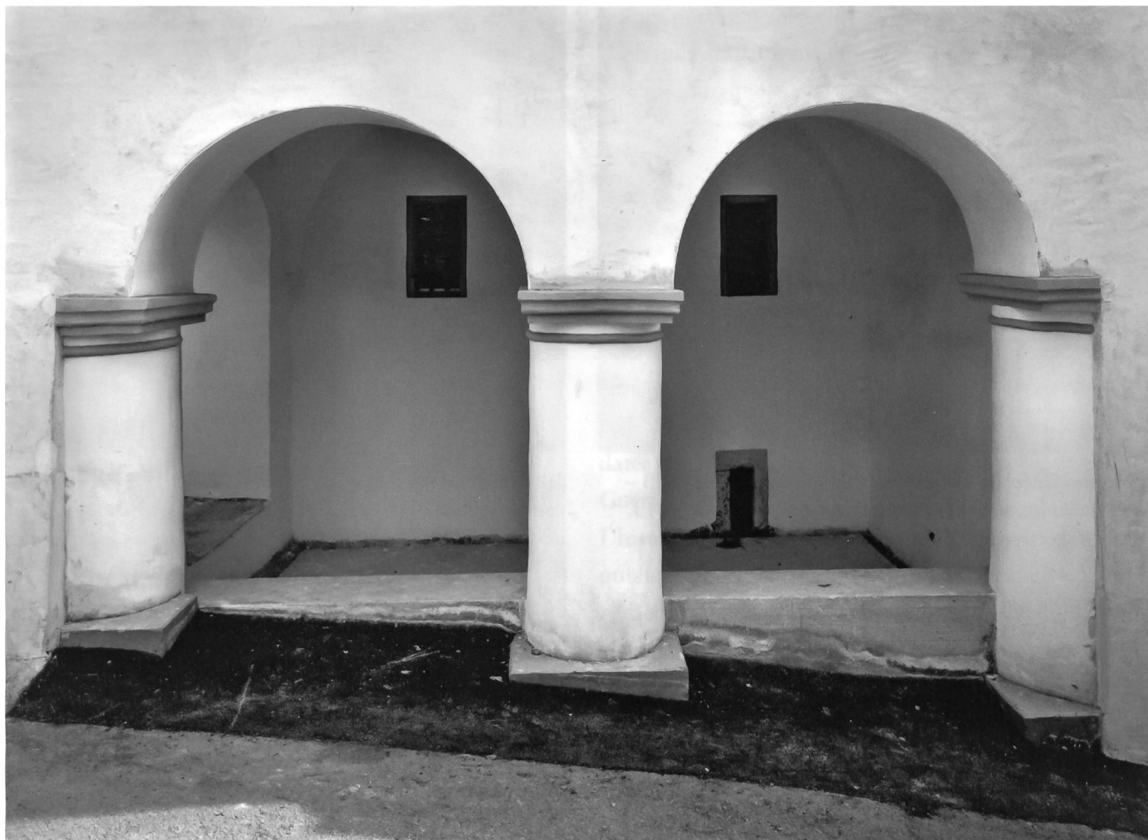
8: Maison Guerrati, façade nord. Détail de l’arcade après les travaux de rénovation – Detail der Arkaden nach der Renovation.
