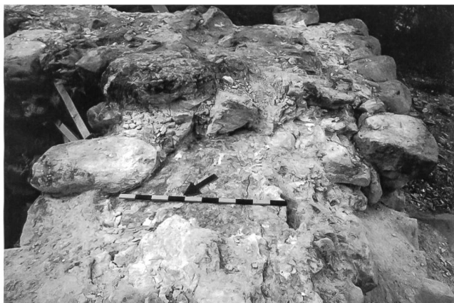
12: Auf der Mauerkrone des Bergfrieds fanden sich nach der Reinigung Reste einer verschmutzten Mörteloberfläche, die als sogenannte Wintergrenze einen Bauunterbruch markiert. Befundaufnahme von 2007.
