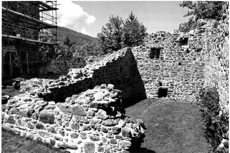
2: Gesicherter Wohnbereich im Norden der Anlage, Blick nach Westen; Gehhorizont ursprünglich tiefer; links Balkenlöcher einer Geschosslage; Westwand: zwei Schartenfenster und rechts oben schräger Rauchabzugkanal (Foto Jürg Rusch, BVG).
