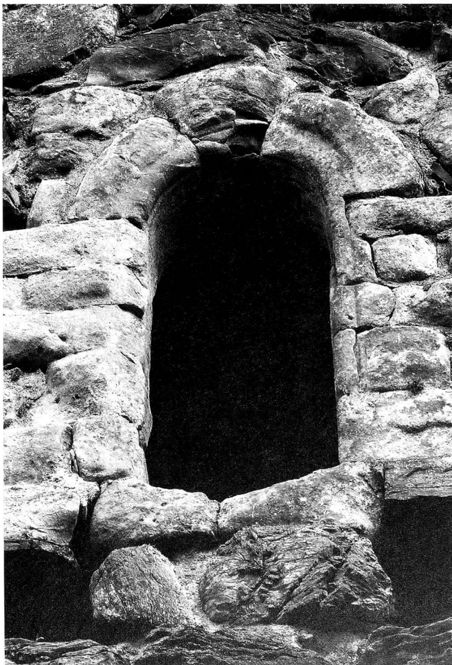
2: Der sorgfältig aus Sandstein gearbeitete Hocheingang des Turms weist starke Brandrötungen auf. Die Erosion hat ihm in den letzten Jahrzehnten stark zugesetzt.
