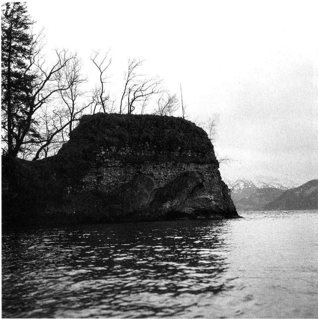
5: Ruine und Insel Altstaad am Meggenhorn 1999. Vom Absturz bedrohtes Mauerwerk auf der Westklippe der Insel.
