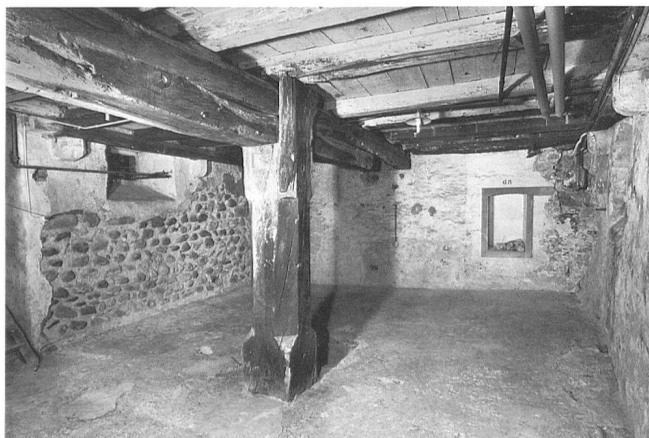
9: Keller im Kernbau III (1317 d) nach Nordosten. Original sind Stud, Sattelholz und Unterzug (12.4) sowie der Mörtelboden (12.2). Linkerhand ist die gleichzeitig errichtete Nordwand (12) sichtbar. Rechts verlief die Stadtmauer (7), die wie die Mauer des Kernbaus II (9) unterfangen wurde.
