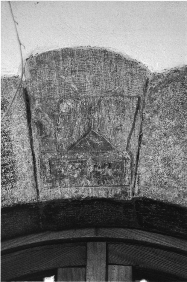
Abb. 11: Soazza GR, Bogen C. Detail des Schlusssteines mit dem Pferch (unten) und dem Amboss (oben).
