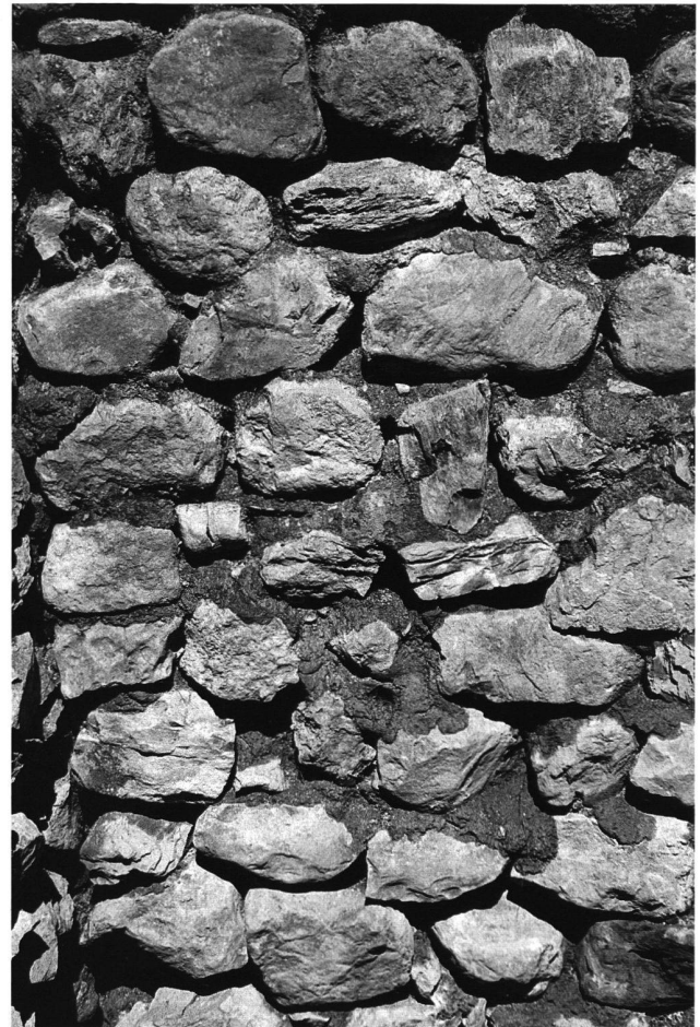
21: Ansicht der Mauer M1 von Süden. Der Mauer Mörtel quillt deutlich aus den Fugen.
