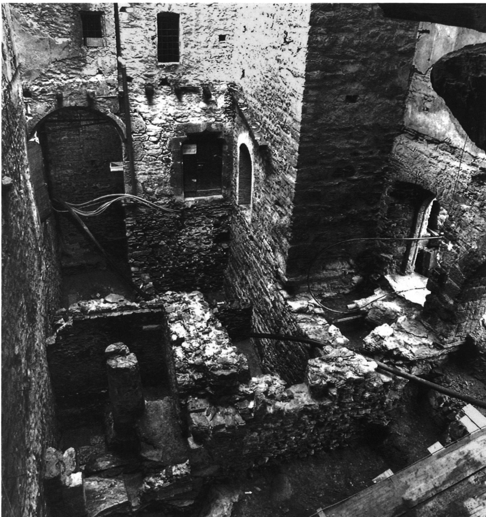
22: Palas-Annex. Übersicht der anlässlich der Ausgrabungen von 1989 entdeckten Mauern. Links unten die gemauerte Spindel einer Wendeltreppe.
