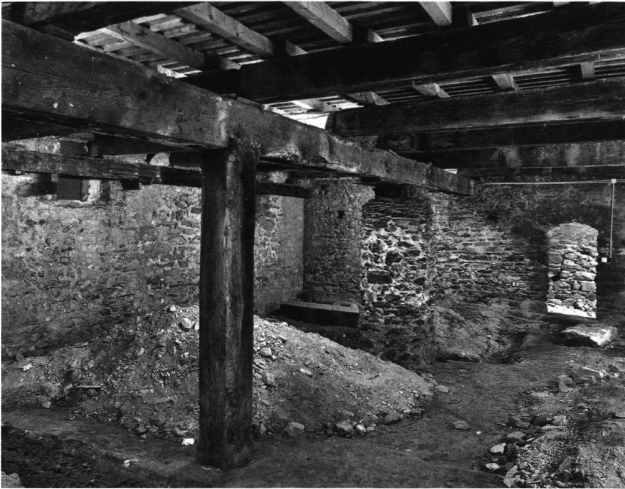
15: Palas, Keller. Aufnahme während der Sondierungsarbeiten von 2001. Hinter der hölzernen Stütze erkennt man die gemauerte Säule und im Hintergrund die Binnenmauer, die den Keller unterteilt. Ansicht gegen Westen.
