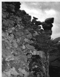
Vorzustand 2001: Die Mauerkronen sind völlig aufgelöst, die Ecken können jederzeit einstürzen.
