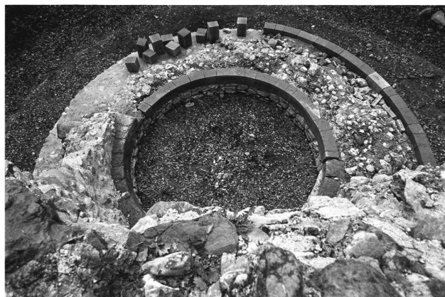
Fig. 22. Vue plongeante sur les vestiges de la tour sud-est en cours de consolidation et de restauration partielle. – Sicht auf die Mauerreste des Südostturmes während der Sicherungs- und Restaurierungsarbeiten. Da für die Mantelsteine kein brauchbarer Stein in der Nähe zu finden war, wird ein rötlicher Sandstein aus den Vogesen zum Wiederherstellen der Mantelmauer verwendet.
