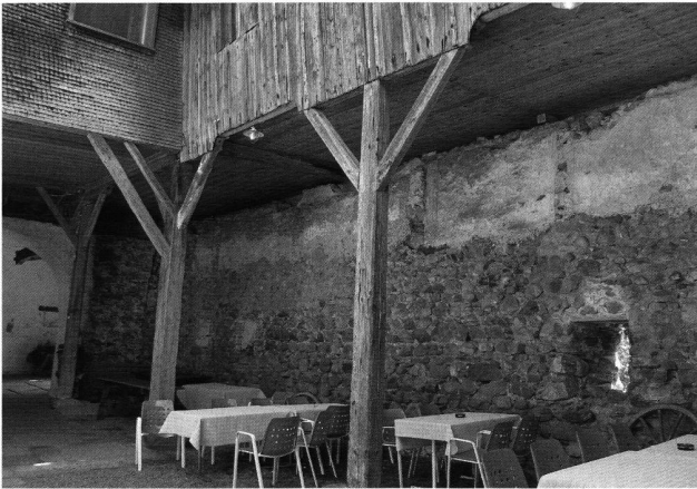
13: Innenseite der südlichen Ringmauer mit Putzresten einer abgegangenen Wehrgangkonstruktion.
