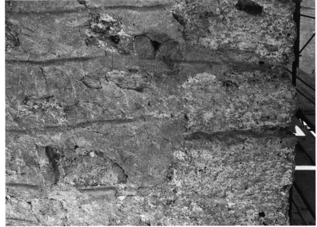
9: Bergfried, Pietra-rasa Verputz II b an der Nordostecke.
