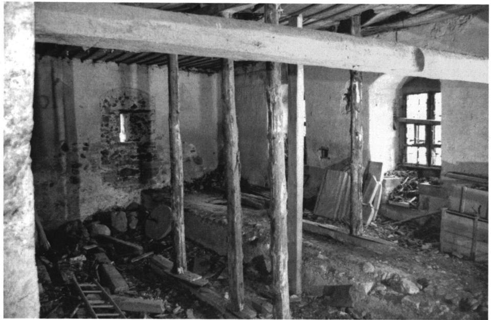
4: Der Rittersaal mit notdürftig abgestützter Decke 1978.
