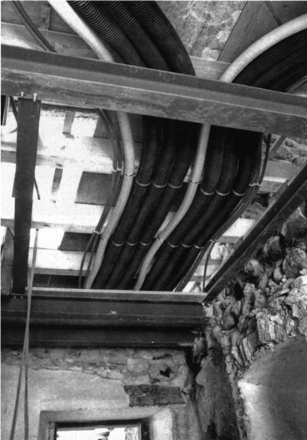
10: Durch eine Decke geführte Leitungsstränge während des Umbaus 1991.
