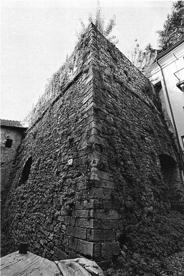
3: Keil des «Rivellino» mit den geneigten Escarpeflächen. Die senkrechte Brustmauer (oben) ist durch einen Kordon (Schnurprofil) abgesetzt.
