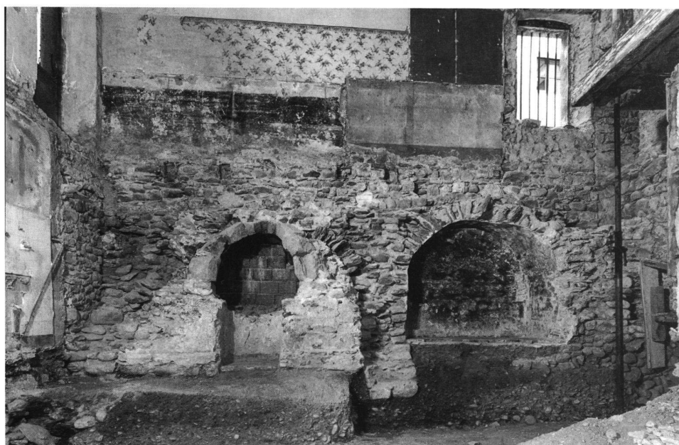
12: Rue des Deux-Marchés n° 34, murs 5 (pont) et 7 (four). – Mauer 5 (Brücke) mit zwei Brückenbögen. In den westlichen (linken) wurde nachträglich der Backofen 7 eingebaut.
