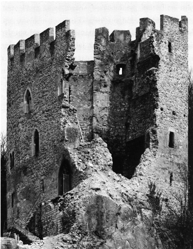
15: Neu-Thierstein SO. Ansicht von W (1985 und 1997). Nebst der schlechten Bauweise führten die im 19. Jahrhundert eingebrochenen resp. veränderten Öffnungen zum Teileinsturz von 1997.
