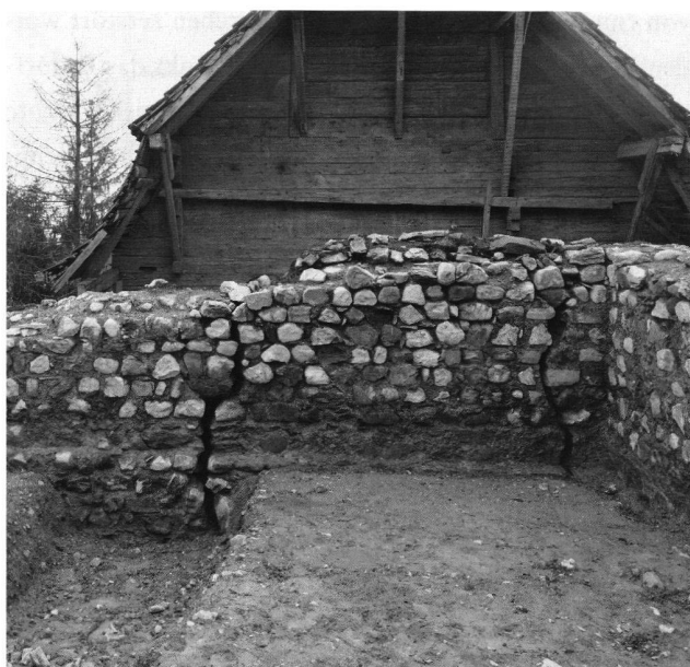
8: Gams SG. Östliche Umfassungsmauer von innen mit den vom Erdbeben verursachten Vertikalrissen.
