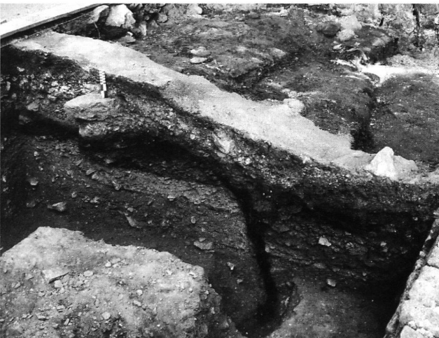
13: Altenberg BL. Der Setzungsriss in der Aufschüttung im Hauptbau wurden vom Gewicht der Aussenmauern verursacht.
