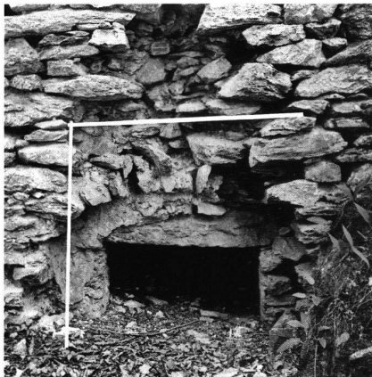
5: Detailansicht des fast zugeschütteten Kellereinganges am Nordostfuss der Turmruine.
