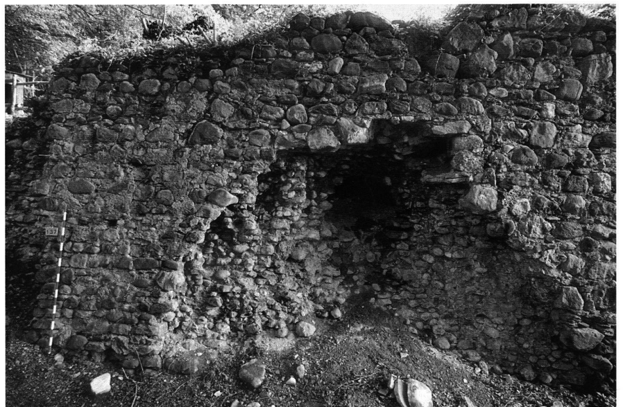
7: Steter Tropfen ... Ausbruch an der Terrassenmauer M24.
