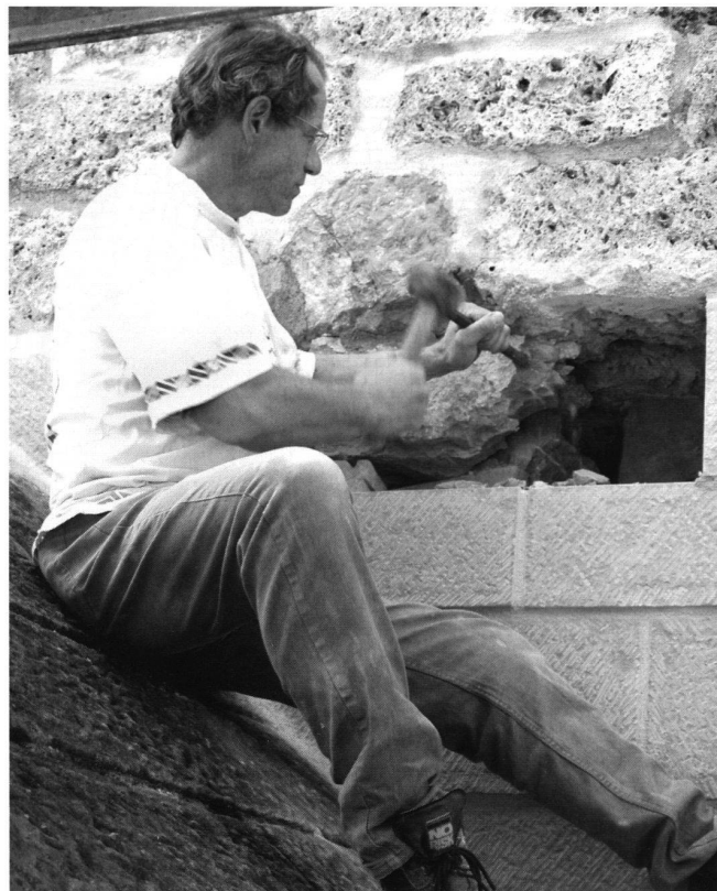
Der Ersatz von schadhaften Schalensteinen ist Millimeterarbeit: Der Steinmetz Hansjörg Hemmi an der Arbeit. Aufn. Thurgauer Zeitung, I. Eberhard.
