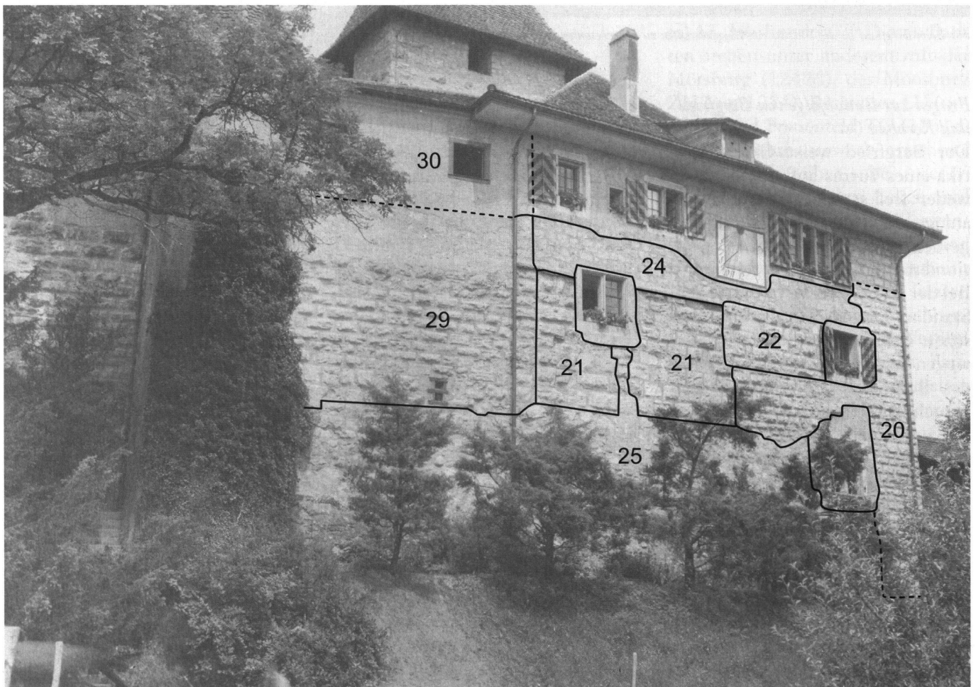
20: Südostfassade des Ostbaus. An den Kernbau Ost (20) mit den gegen Westen absinkenden Steinlagen schliesst sich die erneuerte Mauer (21) an, die sich gegen aussen neigt. Mit der Reparatur (22), der Aufstockung (24) und der Unterfangung (25) fassen wir spätere bauliche Veränderungen. Ins 13./14. Jb. datiert die ebenfalls nach aussen geneigte Schildmauer (29).
