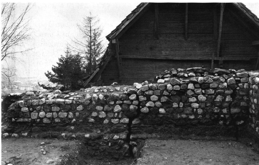
8: Auswirkungen eines Erdrutsches, möglicherweise durch ein Erdbeben ausgelöst: Die im Bereich der Türschwelle auseinander gerutschte und abgesackte Ostmauer (oben, Bildmitte). 7 bis 30 cm breite Vertikalrisse durchziehen die gesamte Dicke der Ostmauer (unten).
