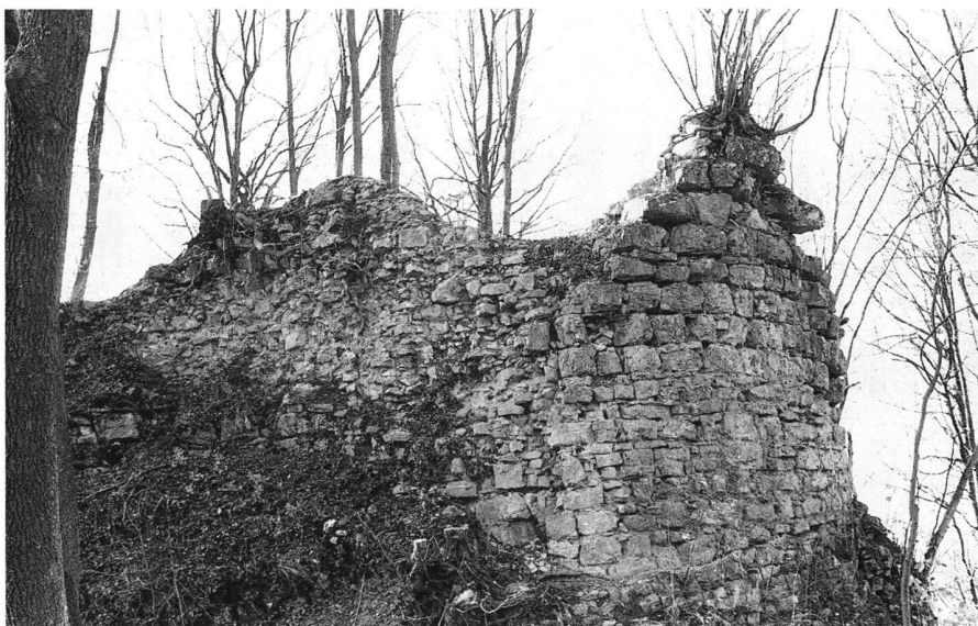
5: Densbüren, Ruine Urgiz (1996). Der Mauermantel des Rundturms ist teilweise in den Graben gestürzt.
