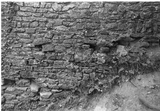
2: Thalheim, Ruine Schenkenberg. Schadensbild im Fundamentbereich.
