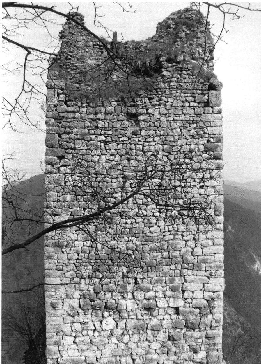
17: Mur M1. La face ouest du château, conçue comme mur bouclier étroit et élevé. La déformation en forme de tonneau du mur est bien reconnaissable; vue de l'W.
