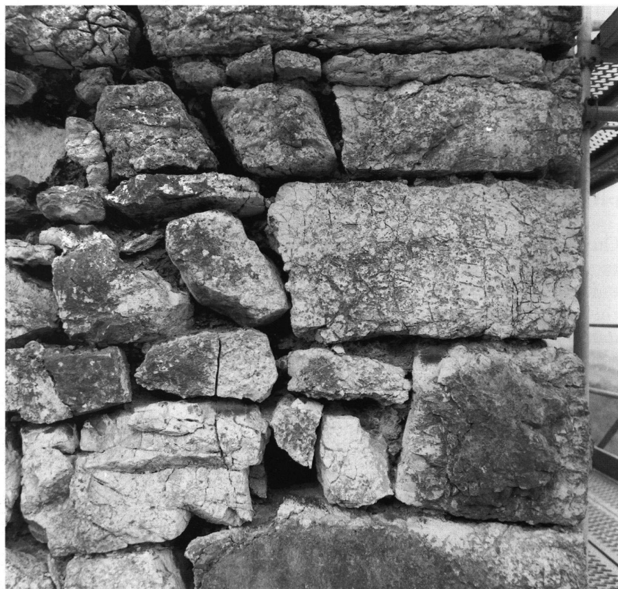
10: Arête des murs M1/M7. Chaîne d'angle construite en gros blocs calcaires; vue de l'W.
