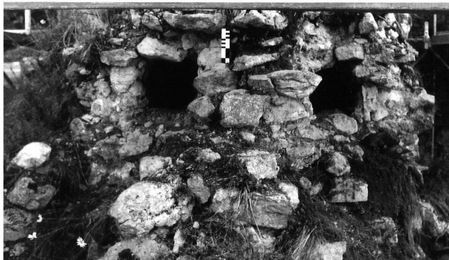
13: Mur M6. Trous des ancrages 11 et 12; vue de l'E.
