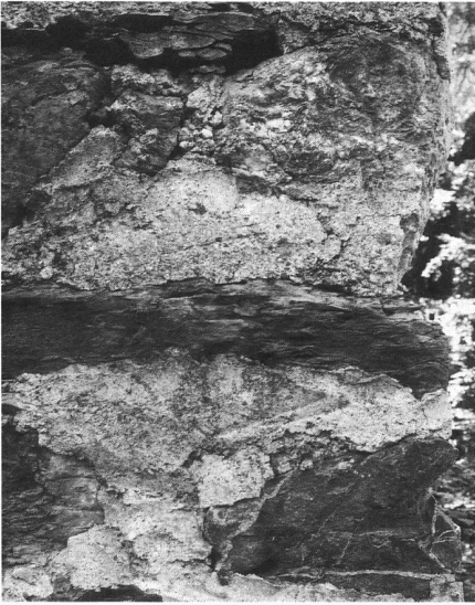
20: Malans GR, Ruine Klingenborn. Glatgestrichener Verputz im Bereich des Eckverbandes des Turmes. Unterhalb der Bildmitte ist der Abdruck einer Spitzkelle zu erkennen.
