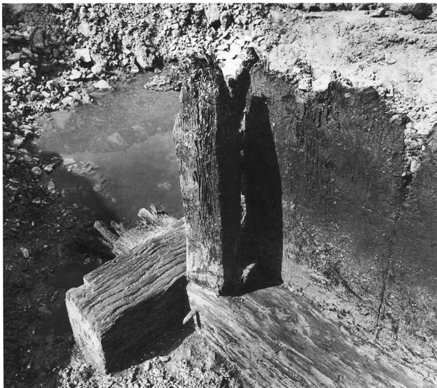
8: Le premier état du musoir nord avec son cadre de poutres et ses planches de coffrage.
