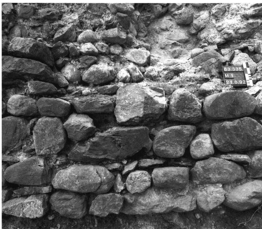
Abb. 7 Die Mauerstruktur des Aussenmantels der Mauer M 1 zeigt gleichmässig lagig geschichtete Steinreihen. Die freiliegende Fundamentunterkante ist deutlich zu erkennen.
