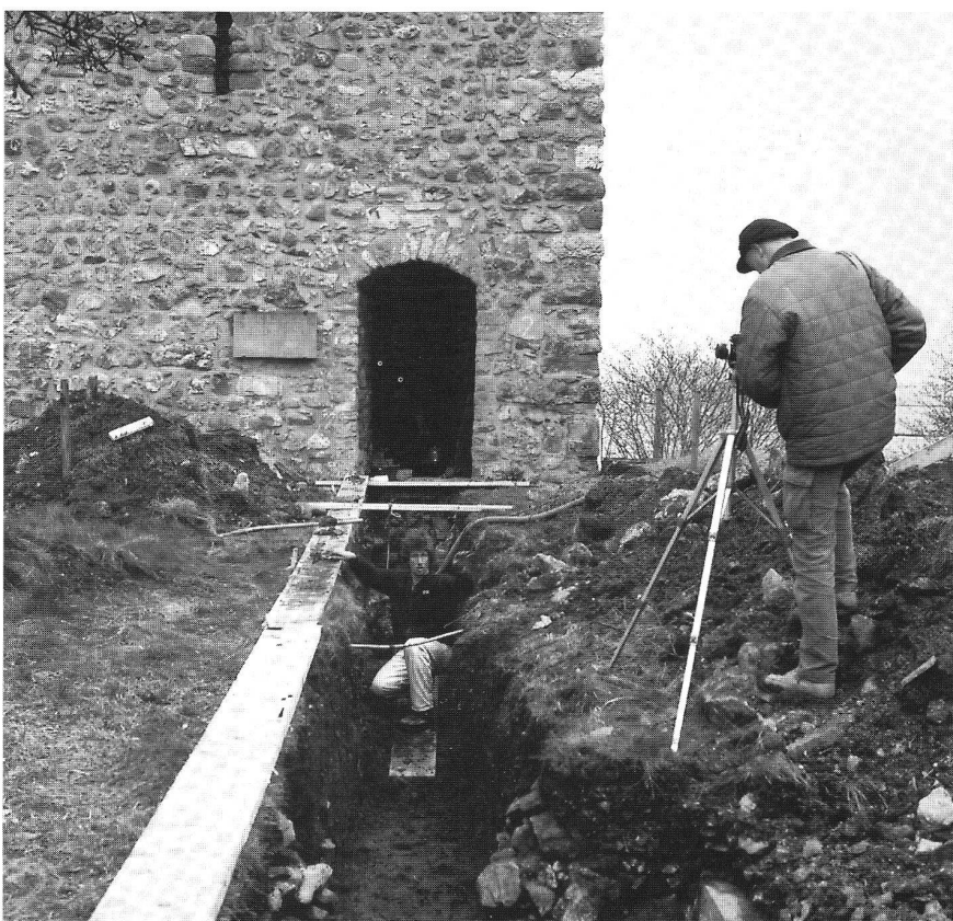
Arbeiten in Schnitt S 2; von S. Im Hintergrund der ebenerdige Eingang. (Aufnahme J. Obrecht)
