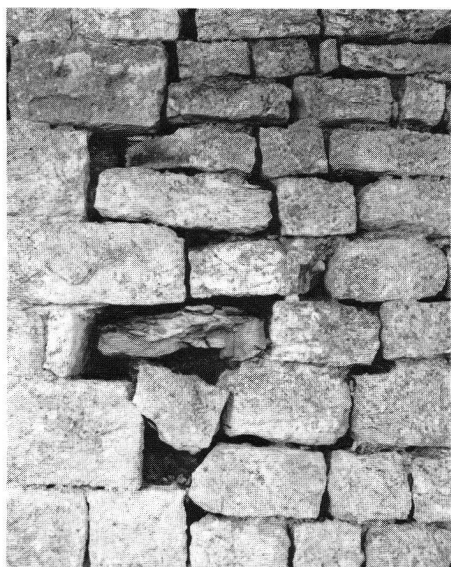
Photo 7 Tour de Milandre, façade nord'ouest, détail, état avant la restauration, changement du système de l'appareil.
