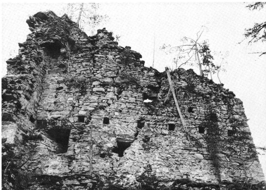
Obertagstein GR. Schildmauer mit starken, durch Pflanzenwuchs verursachten Auflösungserscheinungen. (Zustand vor der Konservierung.)
