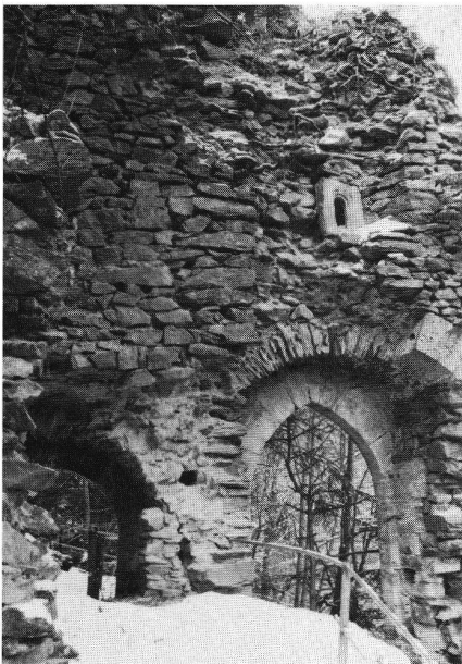
Wieladingen BRD. Der von oben her durch Wurzelwerk zersetzte Torbau ist kurz nach dieser Aufnahme eingestürzt.
