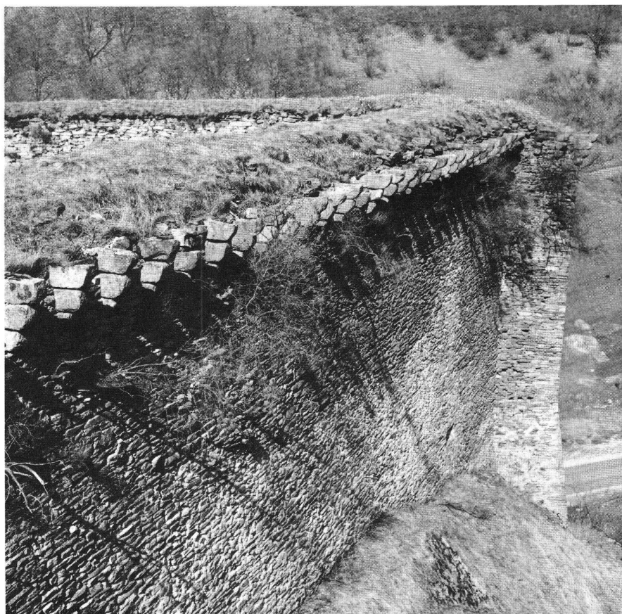
Mesocco GR. Sträucher im Mauerhaupt sprengen allmählich das Steingefüge. Der Grasmantel auf der Mauerkrone war bis kurz vor der Aufnahme mit Bäumen und Sträuchern bewachsen.
