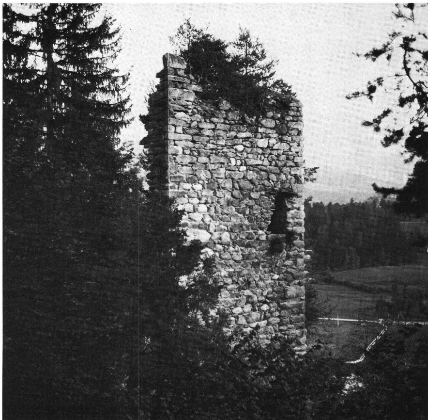
Grüneck GR. Auflösung des Mauerwerkes von oben her infolge Baumwuchses auf der Mauerkrone.
