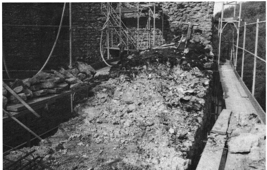
Gilgenberg SO. Mauerkrone des Wobnturmes. Unter der Pflanzendecke (sichtbar im Hintergrund) tritt Mauerwerk im Zustand der völligen Auflösung zutage.
