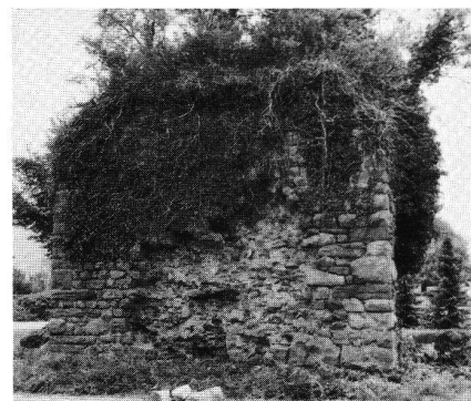
Seedorf UR. Das Mauerwerk des Turmes verbirgt sich unter dichtem Efeu. Die Bresche in der Mauermitte ist auf künstliche Abbruchtätigkeit zurückzuführen.
