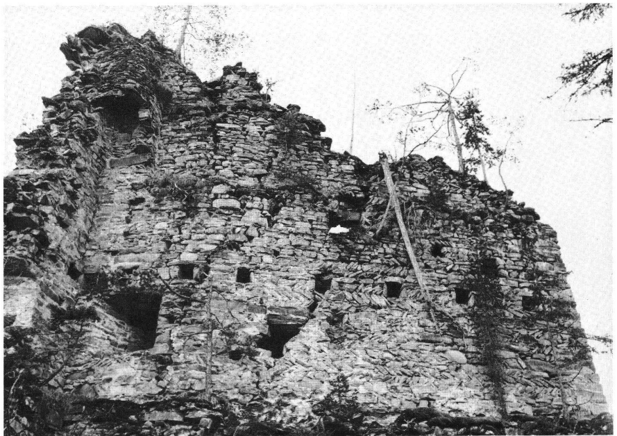
Obertagstein GR. Schildmauer mit starken, durch Pflanzenwuchs verursachten Auflösungserscheinungen. (Zustand vor der Konservierung.)
