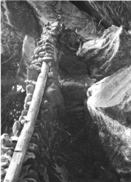
Abb. 7 Hérémece VS, grotte aux fées. Die dünne, gekrümmte Wand des oberen Baues ist um die Holzarmierung herum aufgemauert. Als der Bau teilweise einstürzte, riss das Mauerwerk an der durch das Holz geschwächten Stelle.
