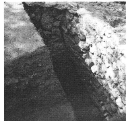
Fläche A, die südwestliche Ecke der Umfassungsmauer. In der südlichen Maueransicht sind die Risse deutlich erkennbar. Unter der westlichen Mauerpartie ist die ältere Mauer M 21 zu sehen.
