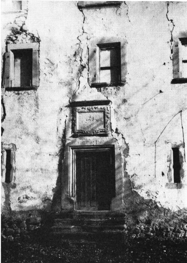
Eingangspartie des Herrenhauses mit Wappentafel. Links und rechts Schlüsselscharten und von Brand stammende Risse.
