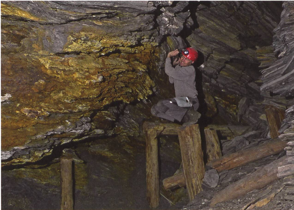
Fig. 17. Trotz allen guten Willens und grösster Anstrengung, hier scheint der Kampf gegen den Zerfall verloren zu sein (Pkt 11). Es ist nur noch eine Frage der Zeit, bis die Stollen für immer verschlossen bleiben (Foto Mirjam Widmer 2009).
