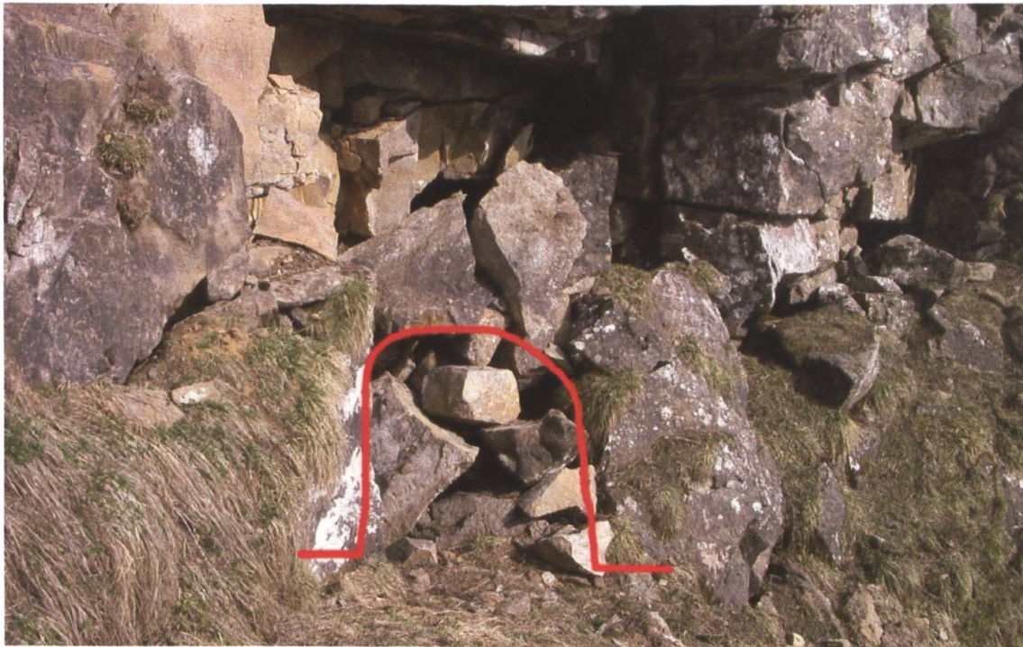
Abb. 28: Egghornstollen, Zustand im Frühjahr 2002. Die ganze Eingangspartie ist hoffnungslos verstürzt. Eine Wiederöffnung ist lebensgefährlich wegen dem stark zerrütteten Fels über dem Stollenmundloch (Foto U. Wenger).
