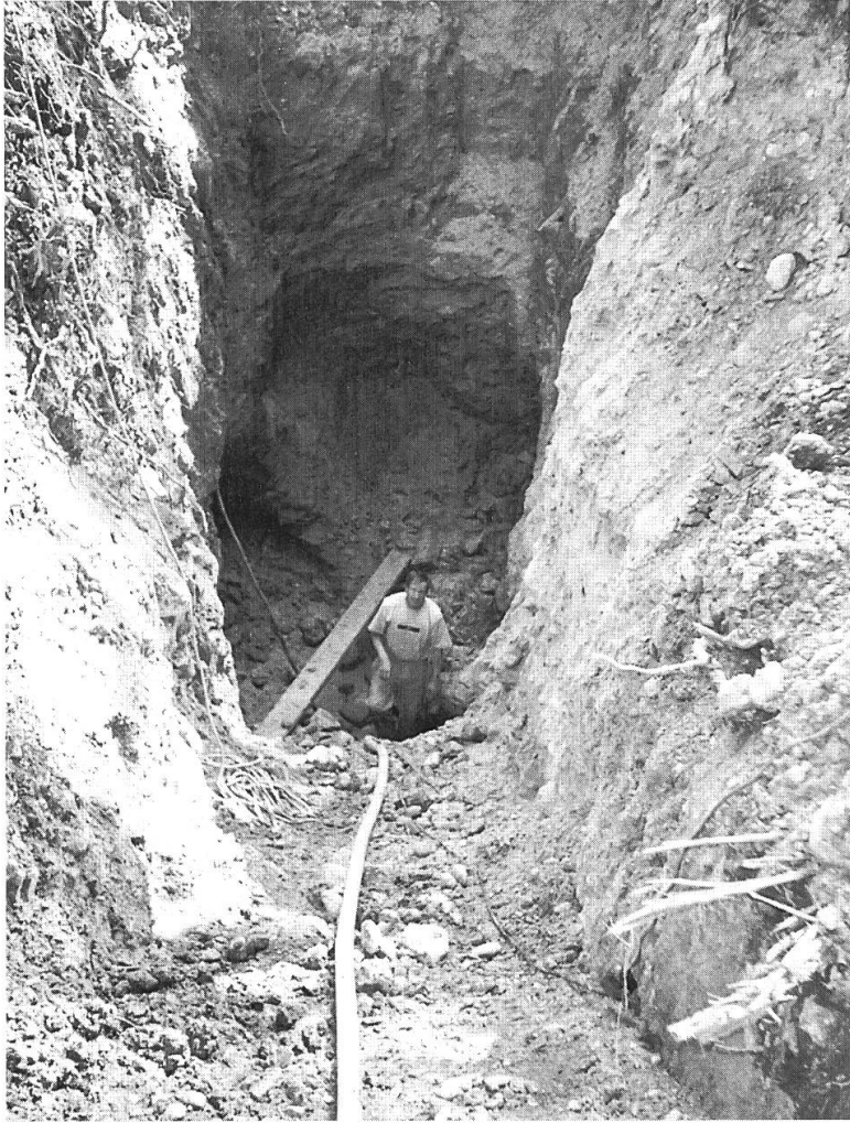
Fig. 13 : Vue de l'accès creusé à la pelle mécanique en 2000 à la «Borne 11» (Les Longevilles/Doubs). Tout en bas, on aperçoit la voûte d'une galerie comblée. Cliché C. Jacquemin-Verguet.
