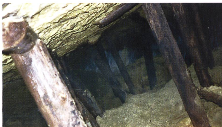
Fig. 11 : Détail des boisages dans la mine des Seignots (Les Longevilles/Doubs). Cliché C. Jacquemin-Verguet.
