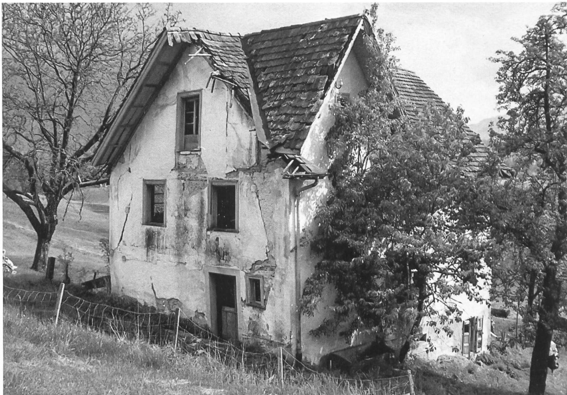
Wohnhaus. Durch Erosion am Zerfall. Kurz vor dem Abbruch. 2.5.1993.
