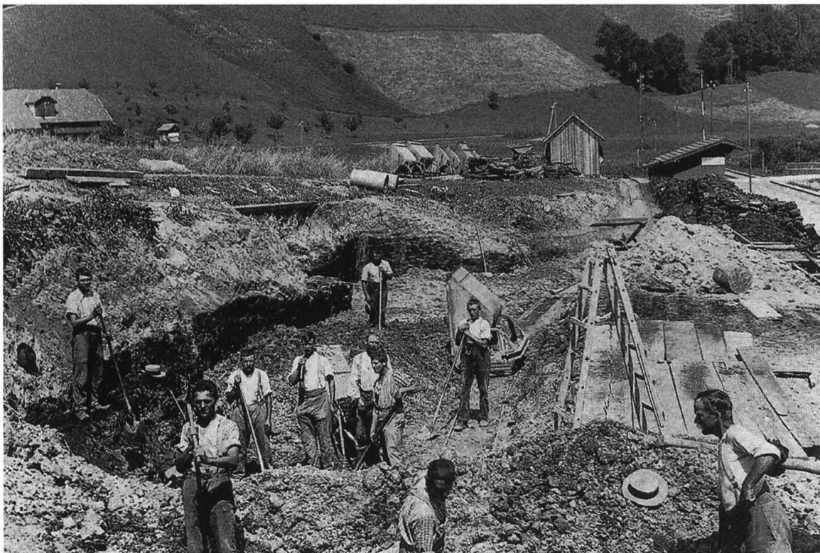
Abb. 3: Blick in die Schieferkohlenabbaustelle bei der Haltestelle Gondiswil. Im Hintergrund rechts die Haltestelle hinter einem Haufen aufgeschichteter Schieferkohlenziegel. Aufnahme Juli 1917. Foto: J. Schär, Gondiswil.
