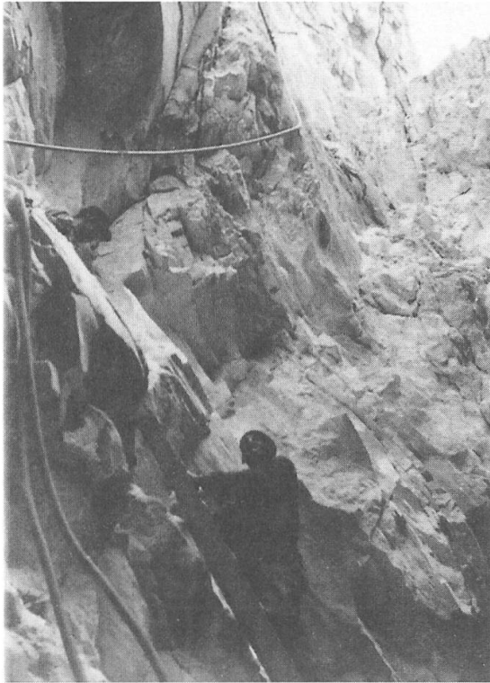
Figure 11: Le marbre était extrait à ciel ouvert à Chez-Larze, avec des moyens légers. Ici, Marius Abbet (en haut) et Alfred Pellaud (en bas), de Chemin, préparent une volée de minage. On se rend compte sur la photo du fort degré de tectonisation du marbre avec les nombreux plans de fractures. (Photo D. Pellaud, 1948).
