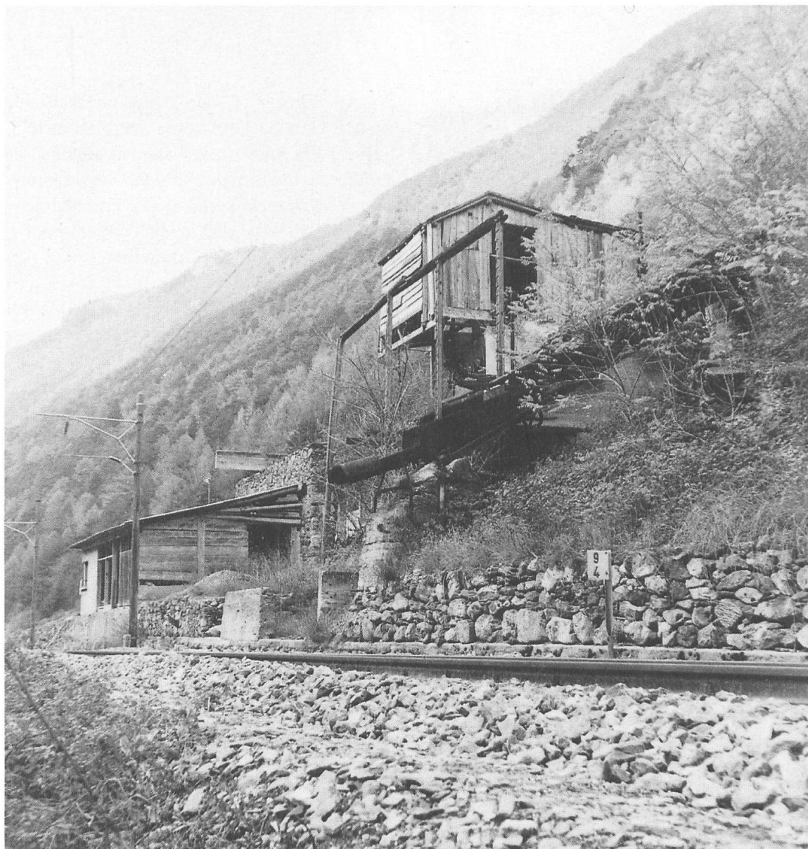
Figure 10: Arthur Amort fait construire en 1927 un téléphérique pour acheminer le minerai à Chandolin près de Bovernier, à proximité de la voie ferrée du Martigny-Orsières. Ces installations ont aussi servi à descendre le fer extrait pendant la Deuxième Guerre mondiale à Chez-Larze. Le téléphérique est à l'abandon depuis 1965. (Photo P. Tissières, 1975).
