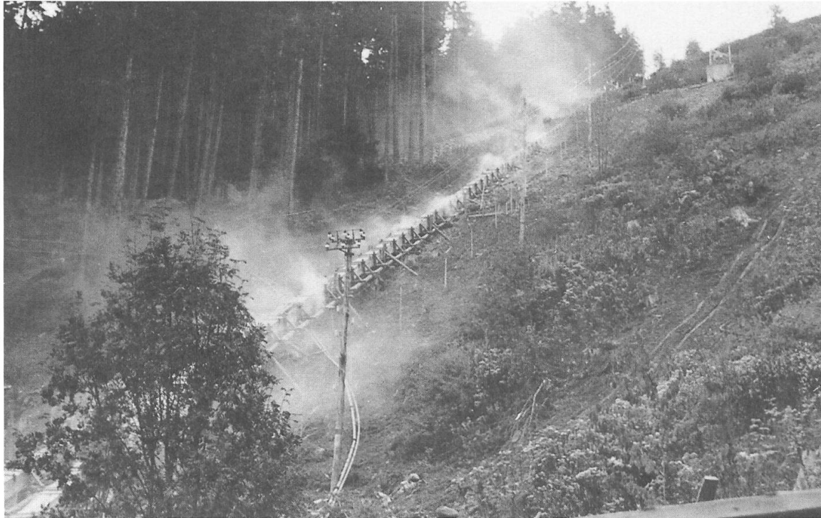
Figure 2: Voici la goulotte en activité: une intense poussière se dégage du chenal, bien qu'il soit fermé. En octobre 1941, l'Ordonnance sur la protection de l'air n'était pas encore en vigueur! (Photo D. Pellaud).
