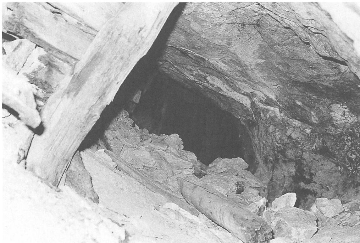
Das Bild zeigt den teilweise eingestürzten Versatz im Hauptabbaugebiet. An einigen Stellen geben die Holzeinbauten dem Bergdruck nach, stellenweise beginnt auch die Decke einzubrechen (Stand 1976).
