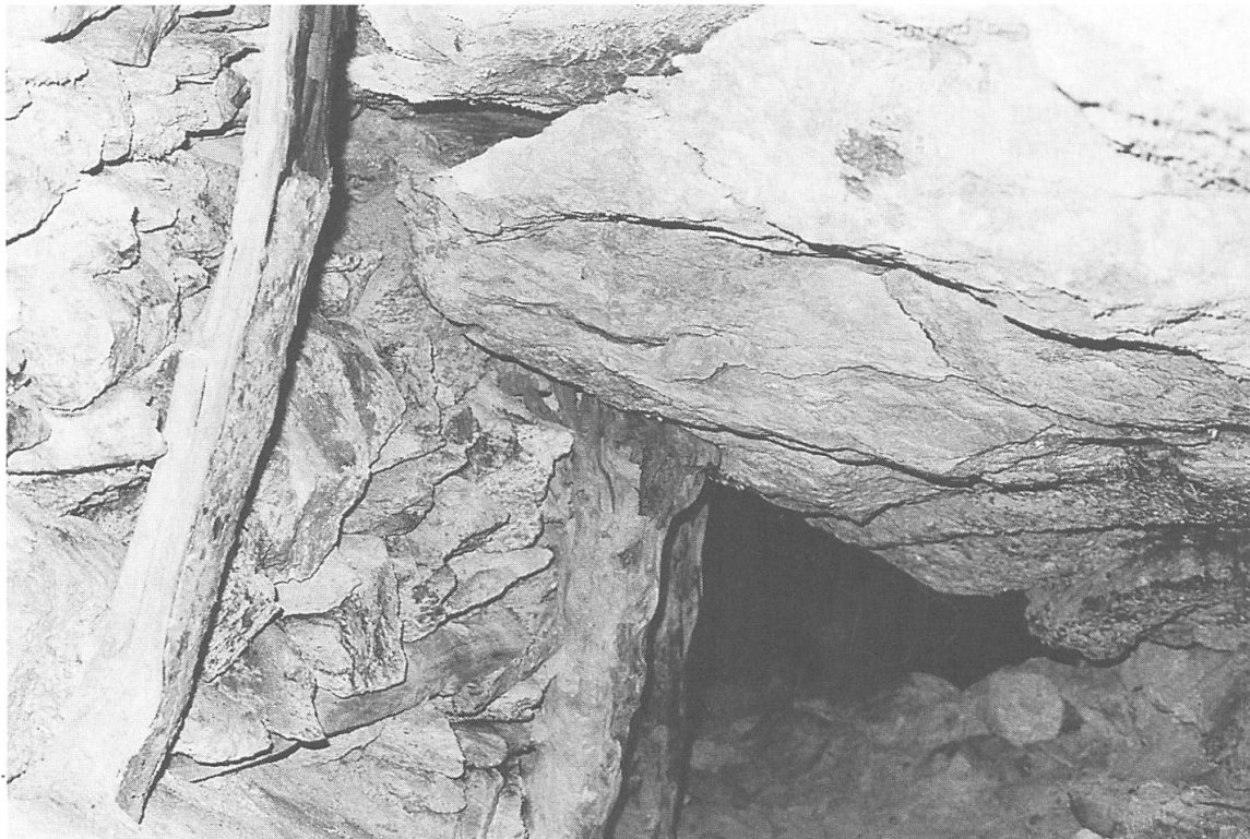
Ein gefährlich von der Decke klaffender «Sargdeckel», notdürftig abgestützt (Aufnahme von 1976). Der stützende Holzträger ist bereits stark beansprucht.
