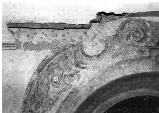
Abb. 13: Einsiedeln, Friedhofkapelle. Die von den Übermalungen befreiten Dekorationsmalereien bei den Fenstern im Kirchenschiff vor den Farbretochen. Am oberen Bildrand ist deutlich zu sehen, dass der zur Malschicht gehörende Verputz hinter der um 1800 eingezogenen Gipsdecke weitergeht.
